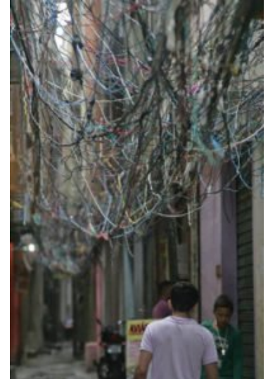
Instalações clandestinas de energia – “gatos” 1
