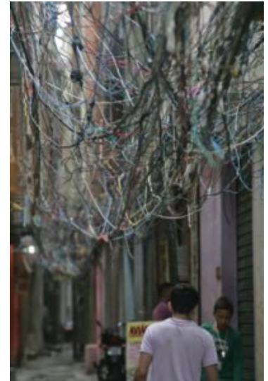
Instalações clandestinas de energia – “gatos” 1
